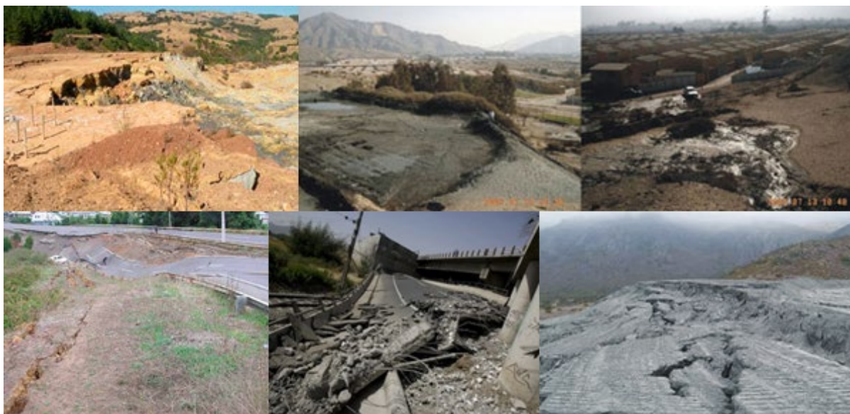
Rys. 2 Przykładowe uszkodzenia skarp i zapór w Chile po trzęsieniu ziemi 27.02.2010 (Źródło: Internet)
